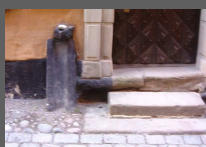
Ostatak kanalizacijskog sustava, ispušt fekalija direktno na ulicu
